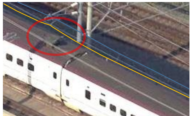
写真 G' : U005_5号車前方のパンタグラフの状況<パンタグラフは折り畳まれているように見える>2016-04-15 午後アジア航測撮影写真(web)の一部拡大加筆
